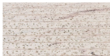
Stockflecken/Schimmel auf der Oberfläche
